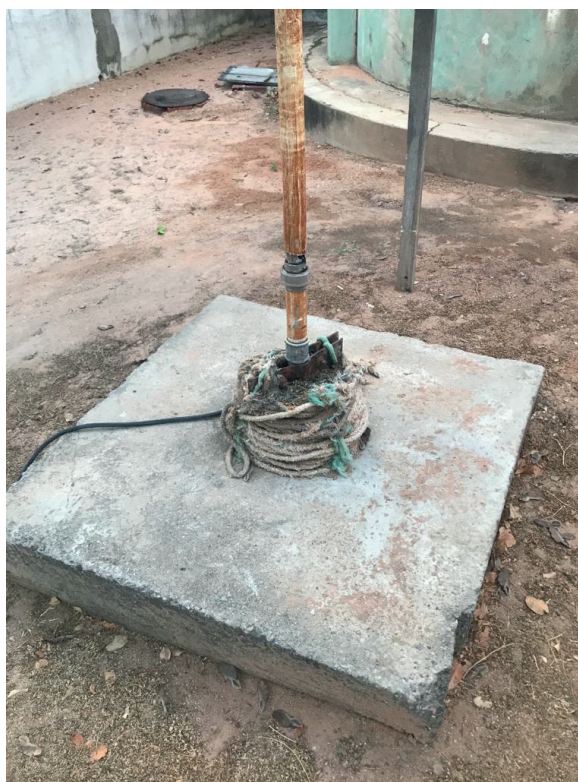
Figura 12: Poço 3: primeiro poço para abastecimento do bairro Bacurau 1.
