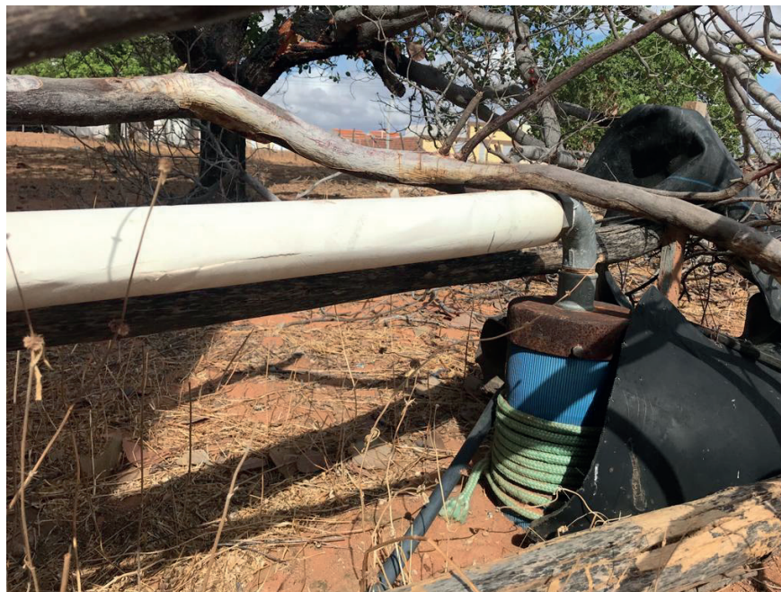
Figura 9 - Poço 7 (poço com proteção adaptada)
