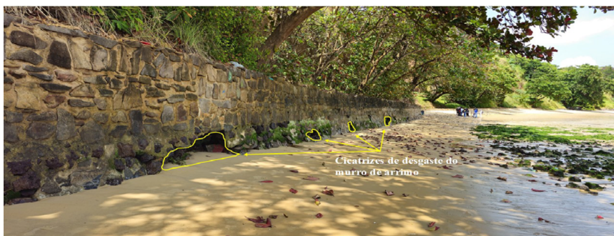
Figura 10: Muro de arrimo com cicatrizes de desgaste e árvores na base da falésia
