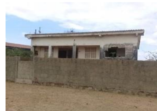
Figura 80: Posto de Saúde desativado. Fonte: Acervo dos autores, 2019.
