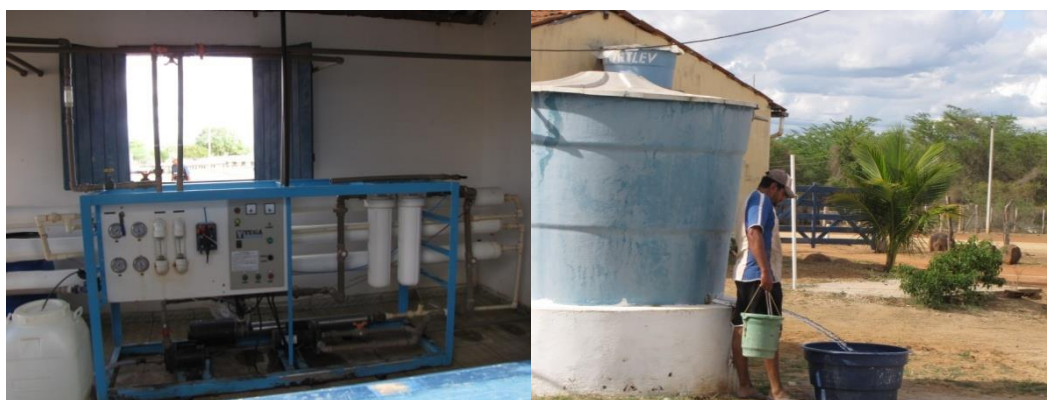
Figura 12: Dessalinizador de água e morador retirando água dessalinizada
