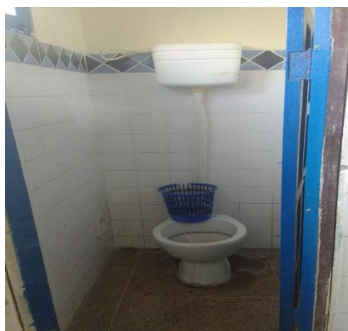
Figura B - Banheiro masculino, descarga com defeito.
