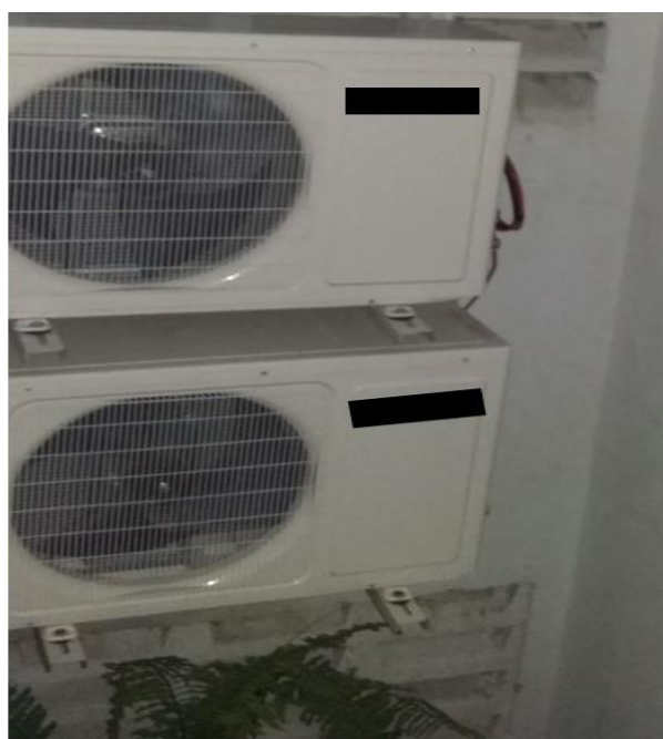
Fotografia 1 – Fotografia das unidades condensadoras
