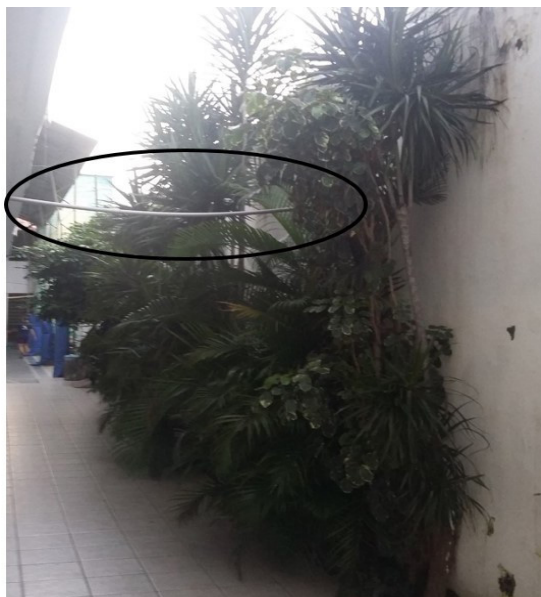
Fotografia 2. Fotografia das tubulações de PVC que fazem ligação com o jardim da escola
