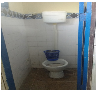
Figura B. Descarga com defeito.
