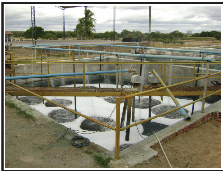
foto 7: Jardim de Piranhas-RN: estação de tratamento de efluentes da Monkey Têxtil S.A.. Fonte: Rosalvo Nobre Carneiro, 2008.
