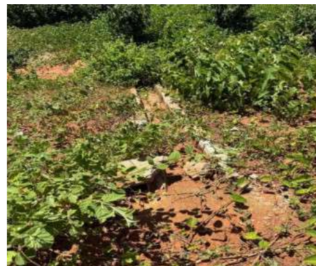
Figura 9 – Canaletas quebradas, árvores e arbustos
