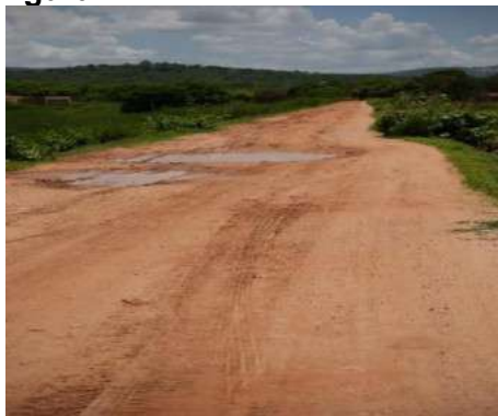
Figura 4 – Afundamentos e buracos
