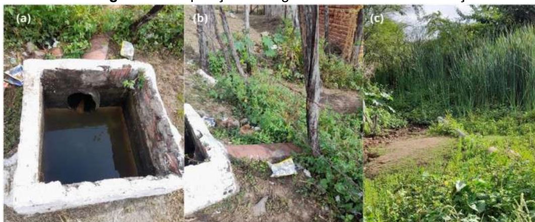
Figura 5 – Disposição de esgoto a céu aberto e destinação final
